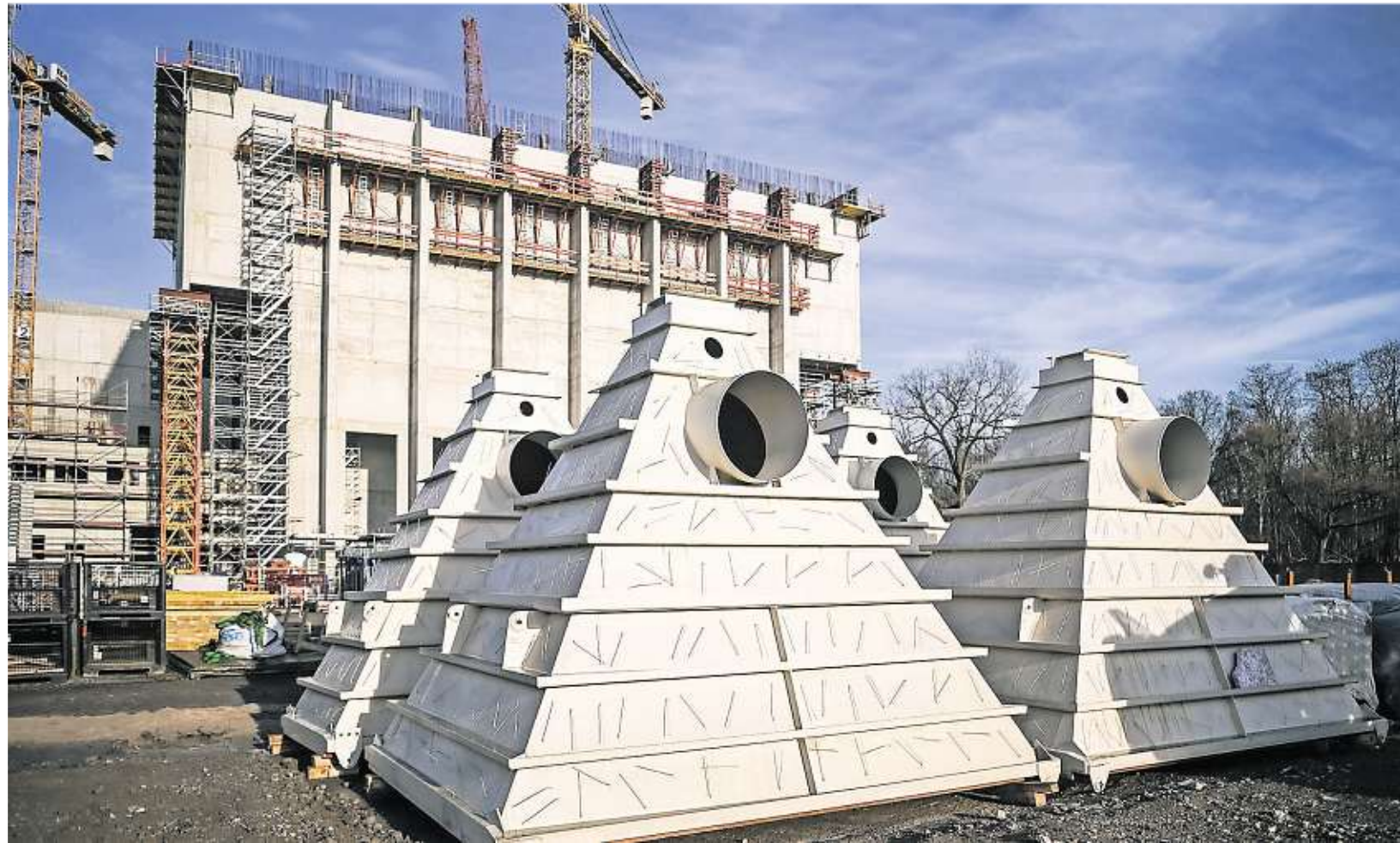
Viele Teile, die für das DHE benötigt werden, werden wie diese Trichter vorgefertigt zur Baustelle geliefert.
